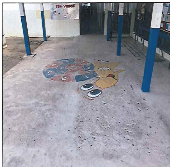
FOTO 03: VISTA DO PÁTIO DE ENTRADA DANIFICADO, ANTES DA EXECUÇÃO DO SERVIÇO. 04/09/2019 - 09:55
