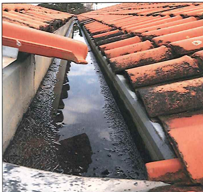
FOTO 02: VISTA DE CALHA ANTES DA EXECUÇÃO DO SERVIÇO, APRESENTANDO ACÚMULO DE ÁGUA. 04/09/2019 - 09:55
