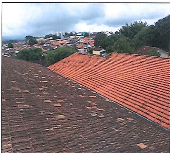
FOTO 01: VISTA DA COBERTURA NECESSITANDO SE SUBSTIUIÇÃO E ALINHAMENTO DE TELHAS. 21/03/2019 - 15:00
