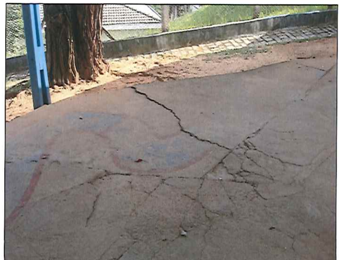
FOTO 08: VISTA DE PÁTIO DE ENTRADA NECESSITANDO MANUTENÇÃO. 24/04/2019 - 09:38
