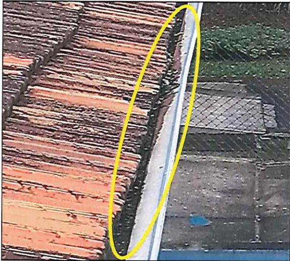
FOTO 05: VISTA DE TELHAS DESALINHADAS, NÃO HAVENDO A DISTÂNCIA NECESSÁRIA ENTRE TELHA E CALHA. 21/03/2019 - 14:56
