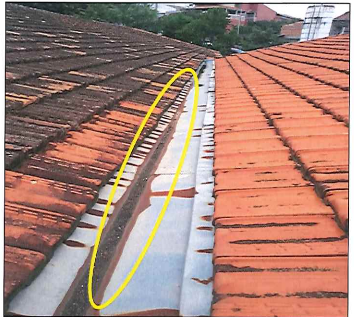
FOTO 06: VISTA DE CALHA METÁLICA EM PROCESSO DE OXIDAÇÃO. 21/03/2019 - 14:56
