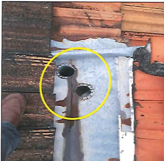
FOTO 07: VISTA DE TUBOS DE QUEDA NECESSITANDO DE REDIMENSIONAMENTO. 21/09/2019 - 14:57
