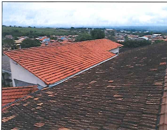
FOTO 04: VISTA DA COBERTURA NECESSITANDO SE SUBSTIUIÇÃO E ALINHAMENTO DE TELHAS. 21/03/2019 - 15:11
