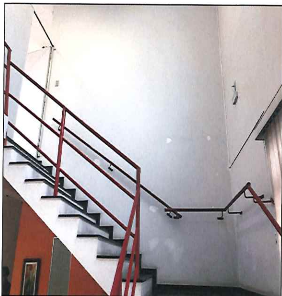
FOTO 07: VISTA DE PAREDE NO HALL DE ENTRADA NECESSITANDO DE PINTURA. 23/08/2019 - 09:43
