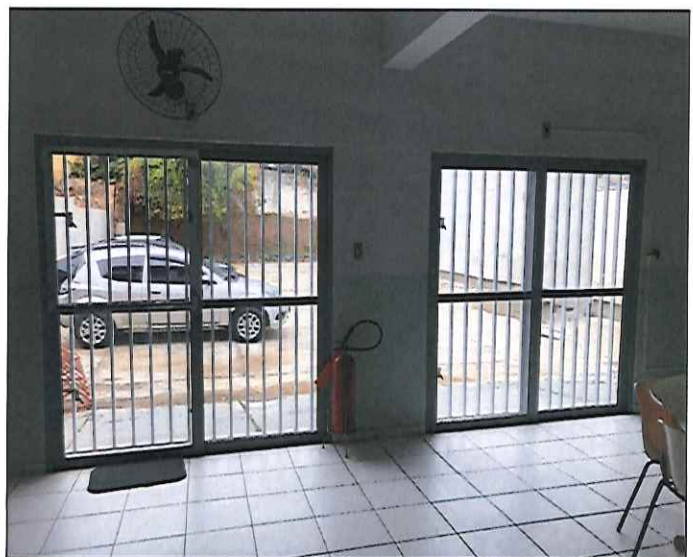
FOTO 04: VISTA GERAL DAS PORTAS A SEREM REPARADOS OS VIDROS. 21/08/2019 - 08:19
