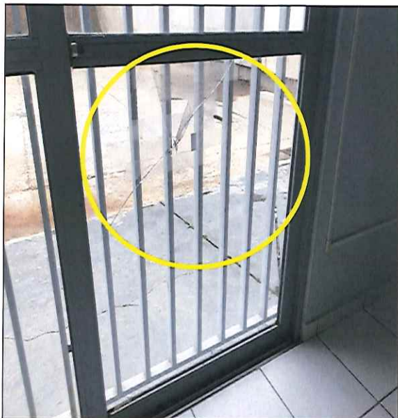
FOTO 03: VISTA DE VIDRO QUEBRADO, OFERECENDO RISCO AOS FUNCIONÁRIOS, NECESSITANDO DE SUBSTUIÇÃO. 21/08/2019 - 08:19
