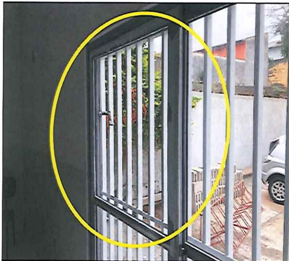
FOTO 01: VISTA PORTA ONDE HÁ A FALTA DE UM VIDRO, NECESSITANDO INSTALAÇÃO DE VIDRO. 21/08/2019 - 08:19
