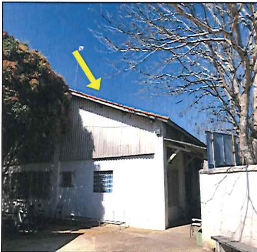
FOTO 07: VISTA DO TELHADO DO BLOCO PRINCIPAL COM NECESSIDADE DE MANUTENÇÃO. 08/08/2019 - 10:43
