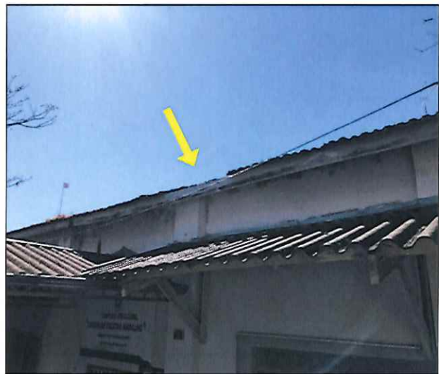
FOTO 06: VISTA DO TELHADO DO BLOCO PRINCIPAL NECESSITANDO REPARO. 08/08/2019 - 10:46
