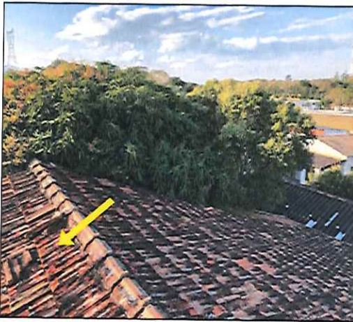
FOTO 01: VISTA DA COBERTURA NECESSITANDO SE SUBSTITUIÇÃO DE TELHAS . 30/07/2019 - 16:24
