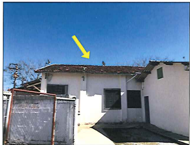
FOTO 08: VISTA DO TELHADO DO BLOCO PRINCIPAL COM NECESSIDADE DE MANUTENÇÃO. 08/08/2019 - 10:44
