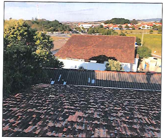
FOTO 02: VISTA GERAL DOS TELHADOS DO BLOCO PRINCIPAL E DO BLOCO SECUNDÁRIO, COM NECESSIDADE DE TROCA DE TELHAS. 30/07/2019 - 16:23
