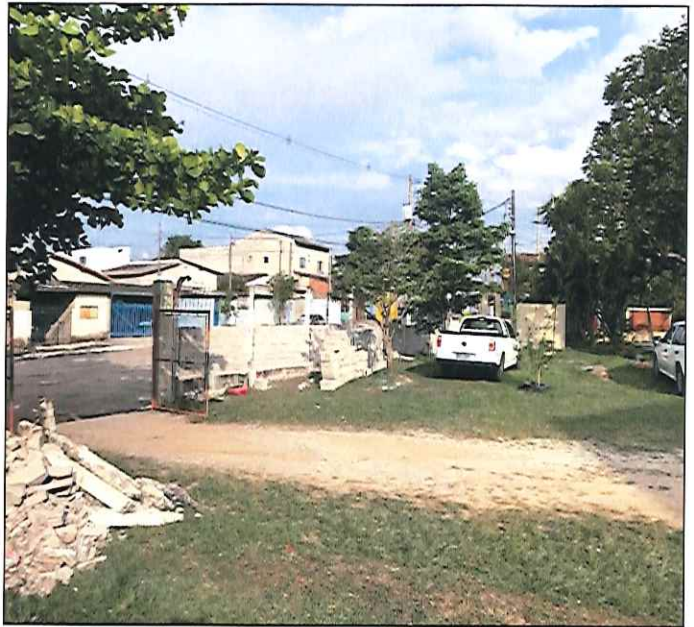
FOTO 06: VISTA DURANTE O SERVIÇO DE RETIRADA DO ALAMBRADO E EXECUÇÃO DE ALVENARIA. 13/11/2019 - 16:30
