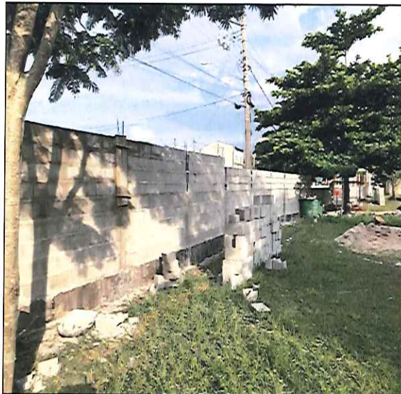
FOTO 07: VISTA DURANTE O SERVIÇO DE RETIRADA DO ALAMBRADO E EXECUÇÃO DE ALVENARIA. 13/11/2019 - 16:32
