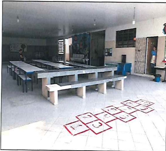
FOTO 01: VISTA DE BANCO DE CONCRETO NO PÁTIO COBERTO ANTES DA EXECUÇÃO DO SERVIÇO. 19/09/2019 - 09:40
