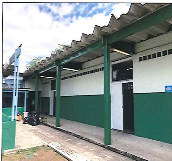
FOTO 18: VISTA DAS SALAS DE AULA À DIREITA, APÓS A EXECUÇÃO DO SERVIÇO. 10/10/2019 - 09:47
