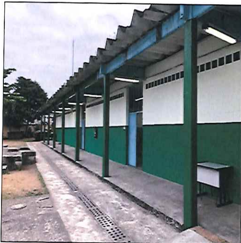
FOTO 15: VISTA DAS SALAS DE AULA À ESQUERDA DO PRÉDIO DURANTE A EXECUÇÃO DO SERVIÇO. 23/09/2019 - 16:00
