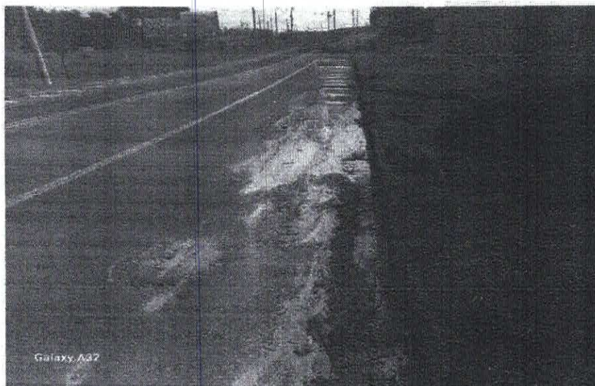
Foto n.º 12 – O risco de acidente está na fragilidade da sarjeta sobre o solapamento visto na foto anterior. Se um veículo pesado passar nesta posição do acostamento estará sujeito a não ser suportado pelo pavimento.
